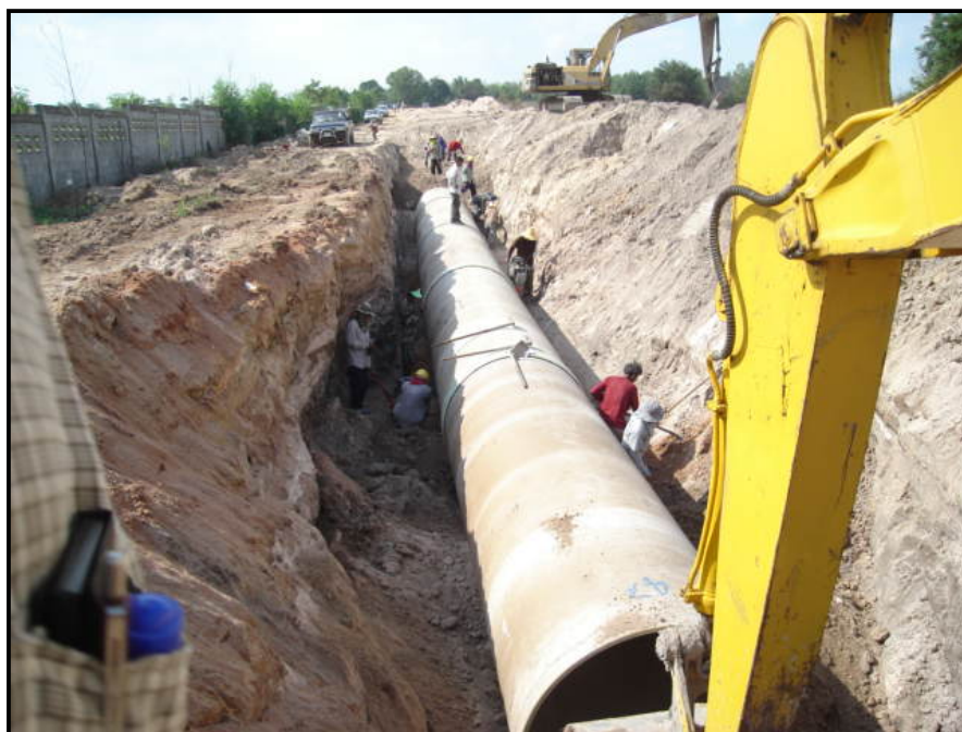
งานก่อสร้างระบบส่งน้ำด้วยท่อจากอ่างเก็บน้ำดอกกรายไปอ่างเก็บน้ำหนองปลาไหล
